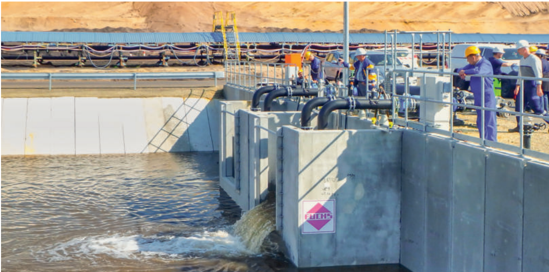
IM TAGEBAU Hauptwasserhaltung mit Rohrtechnik
